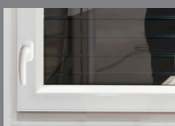
Poignée abaissée conforme à la norme PMR
